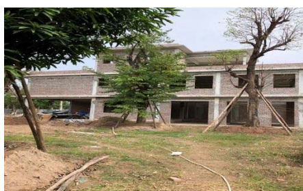
浄化槽提案の現場
