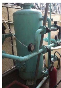
ビル用給水設備(タンク)
