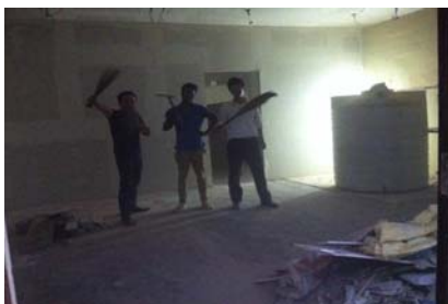
カフェ開店前に家具屋の経営者の方と共に、完成をイメージしながら改装を手伝った。
