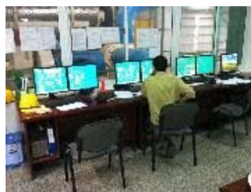
コントロールルームによるラインの監視 (生産ラインは原料投入を除き全て機械化されていた)
