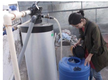
取引先縫製工場で浄水装置の点検
