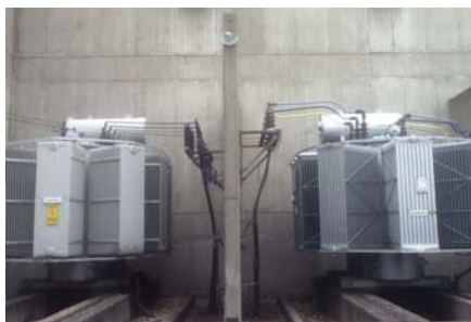
変電設備の油圧点検
