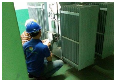
変圧器の稼働状況の確認
