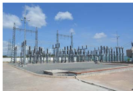
同変電設備 (同省と近隣省へ各1回線で送電)
